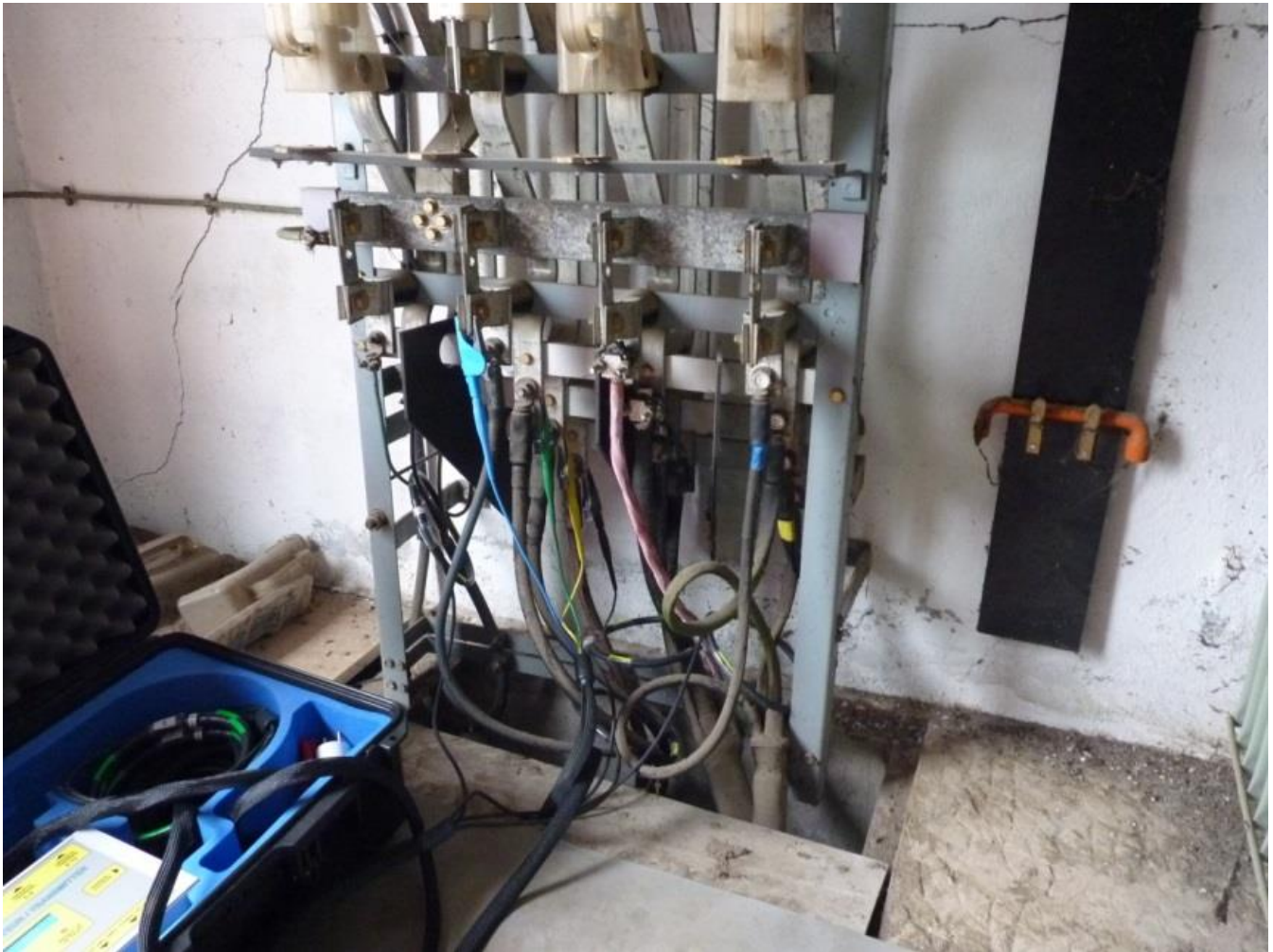
Vue générale, tension et courant.
