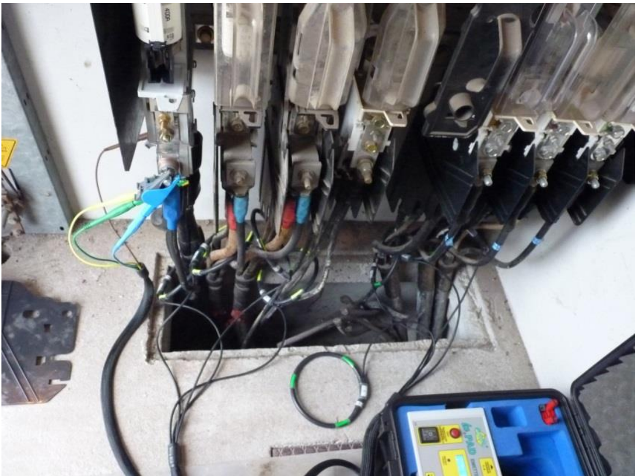
Vue générale, tension et courant.
