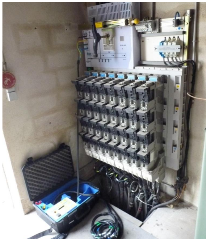
Vue générale, tension et courant.
