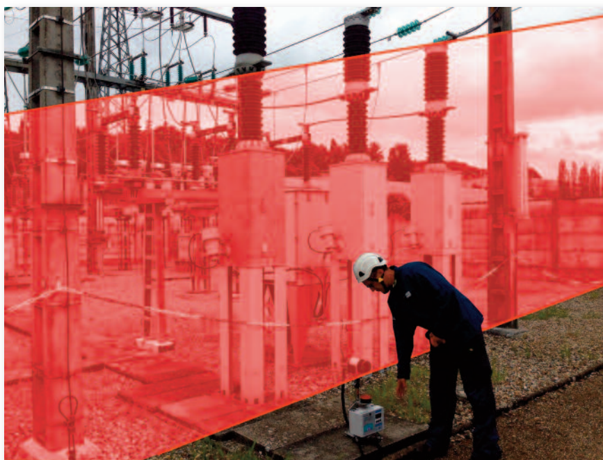
Opérations de maintenance dans un poste de Haute Tension
